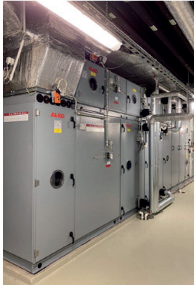
Durch Optimierung des Volumenstroms und der Betriebszeit der Lüftungsanlage ist der Stromverbrauch um rund 20 % gesunken. Foto: Zollernalb Klinikum
