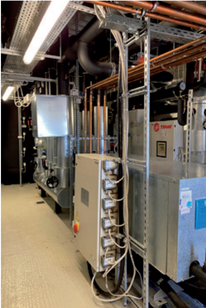
Ein großer Teil des Stromverbrauchs des Zollernalb Klinikums entfällt auf die Kältemaschinen. Foto: Zollernalb Klinikum
